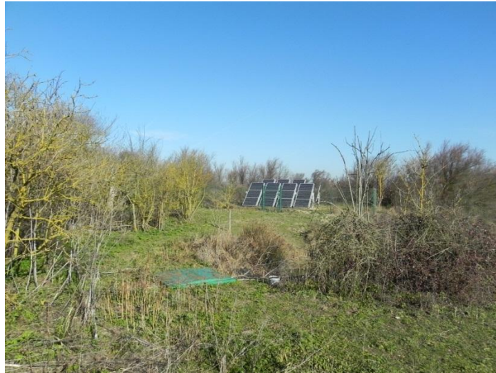
La station de pompage photovoltaïque : vue d'ensemble
