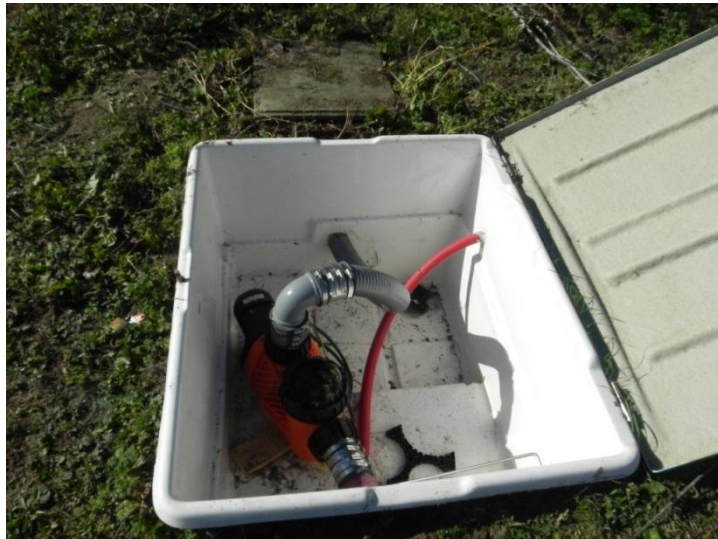
La pompe dans son caisson enterré
